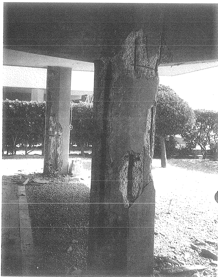
Fig. 29. Distacco del conglomerato di ricoprimento ed inizio della ossidazione delle armature di un fabbricato in riva al mare.
