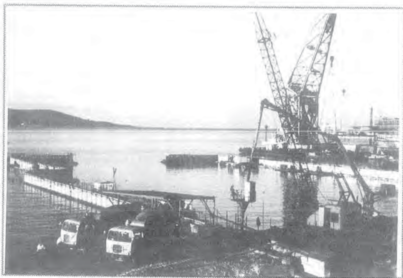
Fig. 7 - Una veduta del cantiere del bacino di carenaggio di Trieste (1980) durante una fase del getto subacqueo.
