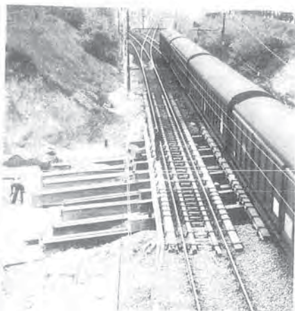
Foto 3 - Linea F.S. Scalo merci rafforzata con fasci di binari in corrispondenza dei due monoliti telescopici. Sono visibili le travi di manovra binate.
