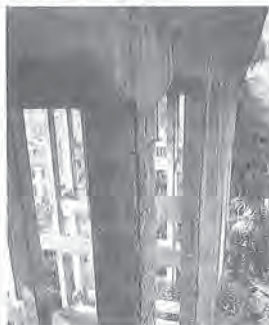
Foto 1 - Struttura in c.a. degradata
