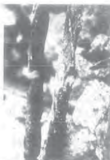
Foto 3 - Ossidazione e corrosione di armatura in ferro non passivata
