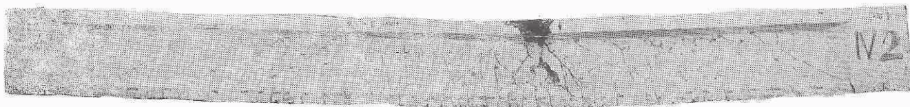
Fig. 53 - Trave IV 2 . Lato 1: vista di insieme.
