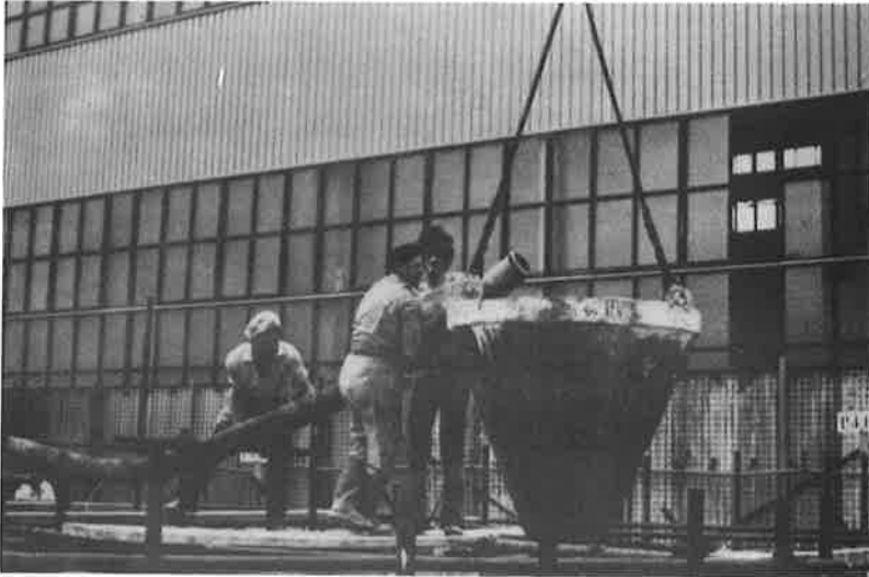
Fig. 13 - Prove di campo per il getto di calcestruzzo reoplastico : inizio del getto (A), autolivellamento del calcestruzzo (B e C).
