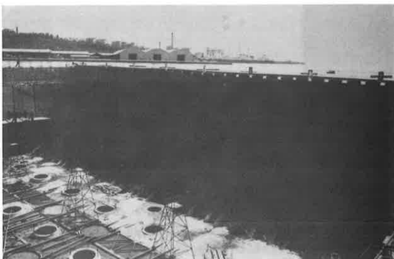
Fig. 20 - Veduta della platea gettata in subacqueo : sullo sfondo lo sbarramento per l'acqua del mare.
