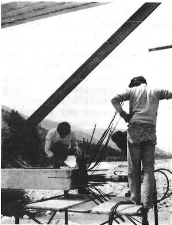
Fig. 19 - L'aspetto di due conci di trave assemblate e pronti per il varo sulle pile provvisorie.
