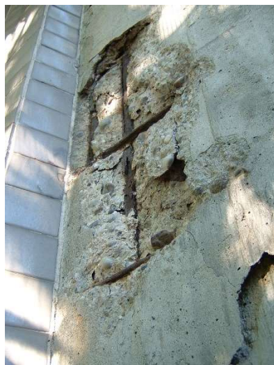
Chiesa dell'Ospedale San Carlo a Milano Distacco del copriferro dovuto alla corrosione dell'armatura di un pilastro in c.a.
