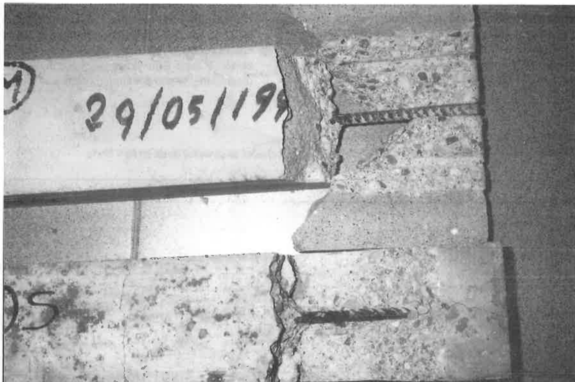
Fig. 3 -Particolare dello stato di ossidazione delle barre.
