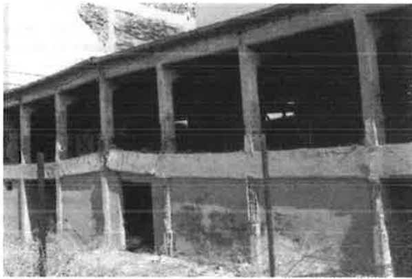
Fig. 3A – Calcestruzzo fortemente degradato
