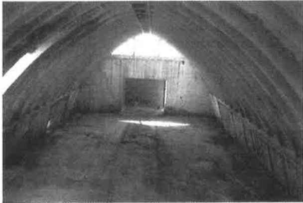
Fig. 8 – Cedimento di parte del capannone
