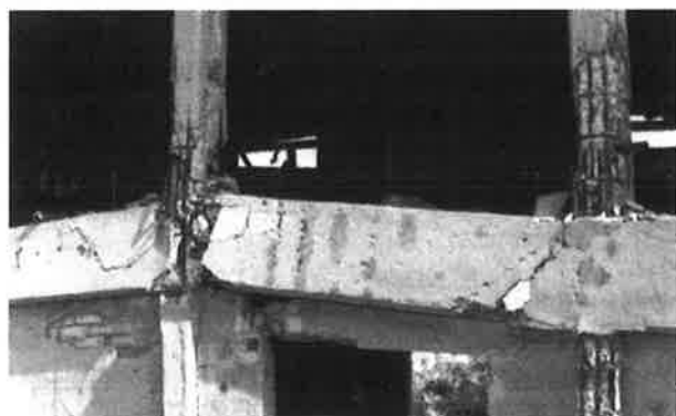
Fig. 3 - Calcestruzzo fortemente degradato
