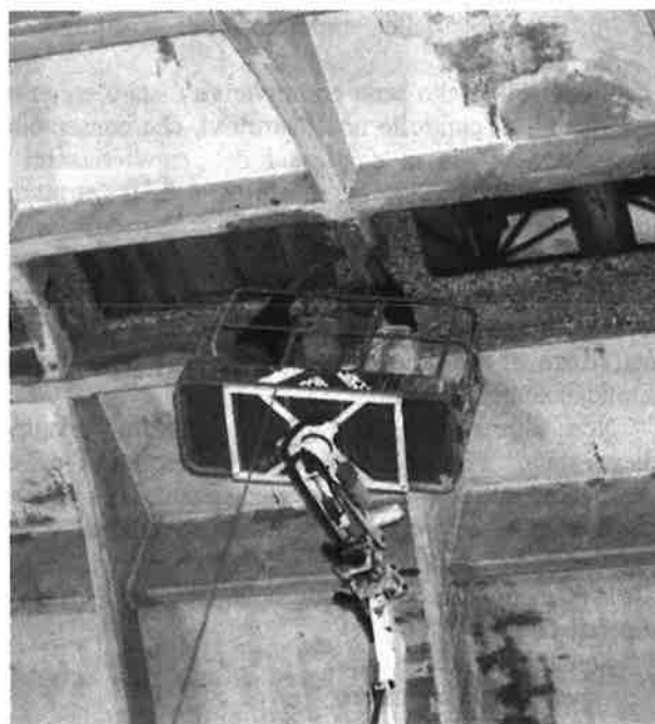
Fig. 4 - Calcestruzzo in condizioni discrete
