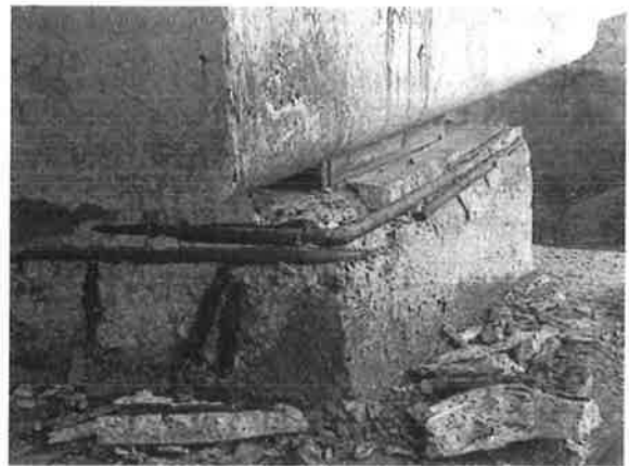
Fig. 4 Parte d'opera: appoggi; elemento: baggiolo. Difetto: fenomeni di rottura localizzata del calcestruzzo . Possibili valori degli Indici: V_1 = 50 ; V_2 = 30
