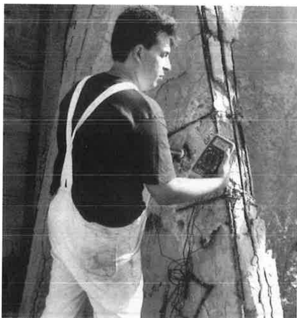
Fig. 7 - Degrado dei contrafforti
