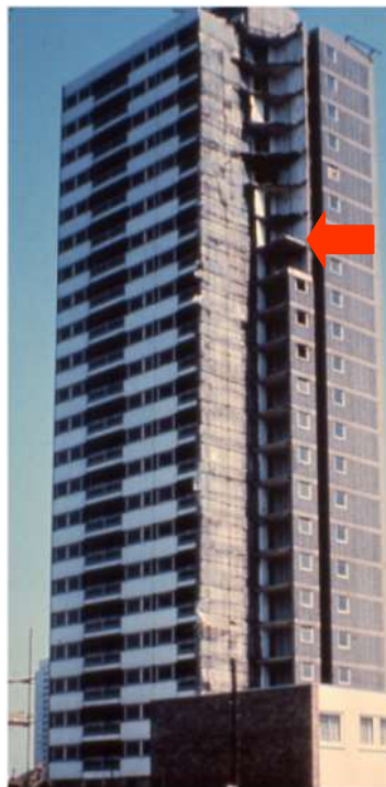
Fig.3 – Collasso progressivo di un angolo della torre di Ronan Point con l’ambiente luogo dell’esplosione di gas al 16° piano
