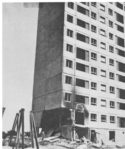
Fig. 6 – Edificio dopo espulsione di due pannelli portanti d'angolo per esplosione di gas: la struttura restante è integra
