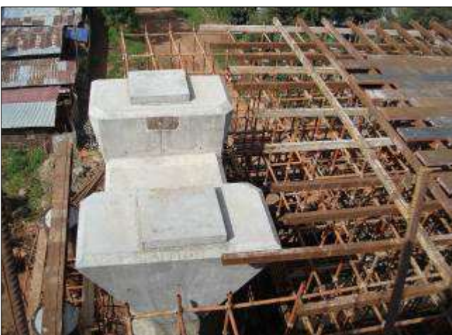
Figura 14 - Fasi esecutive. Vista di pulvino e sella per l'inserimento del ritegno antisismico
