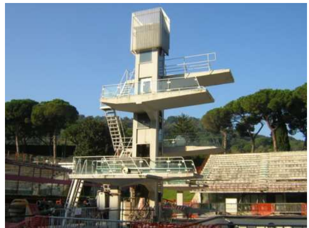
Figura 5 – Il trampolino prima degli interventi
