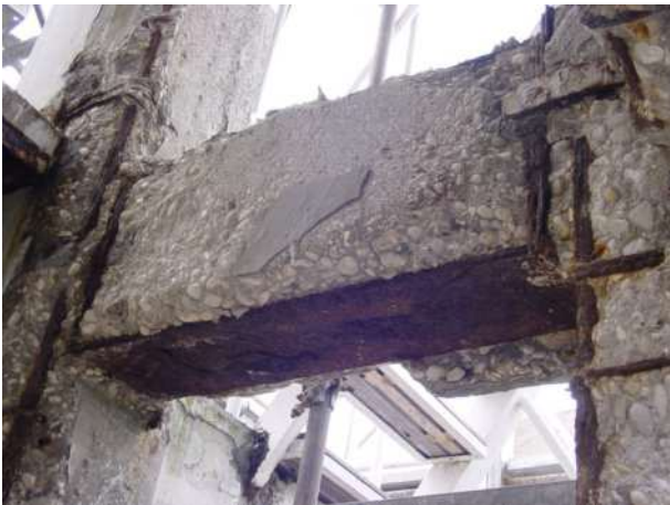
Figura 6 – Stato di forte degrado e ossidazione dei ferri
