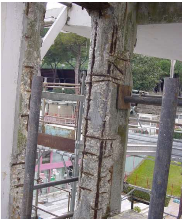
Figura 7 – Le staffe dei pilastri sono state consumate dalla ruggine
