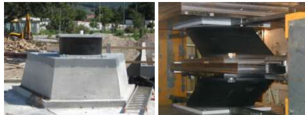
Figura 11 - Isolatori in opera ed al banco di prova
