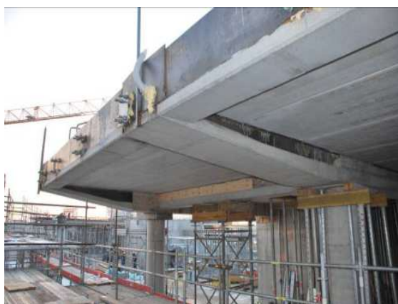
Figura 25 - Vista intradosso elementi PREM con rastremazione della sezione: solaio di copertura. L5 (+155.50)
