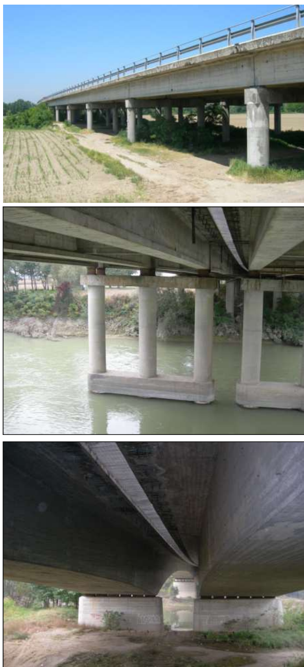
Figura 1 – Viadotto sui fiumi Tanaro e Bormida: impalcato in c.a. (in alto), impalcato in c.a.p. (in mezzo) e impalcato a cassone (in basso).
