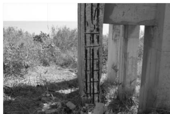
Figura 2 - Degrado delle pile del viadotto Maddalusa
