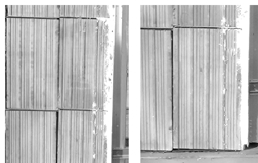
Figura 16 – A sx, scorrimento dei giunti tra i blocchi. A dx, rotazione dei blocchi alla base della tamponatura
