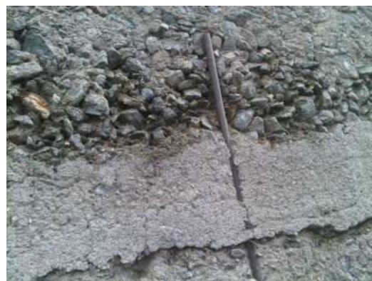
Figura 3 – Tipico fenomeno di erosione superficiale
