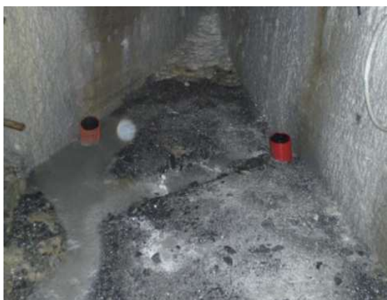
Figura 4 –Eccessiva permeabilità e deposito concrezioni
