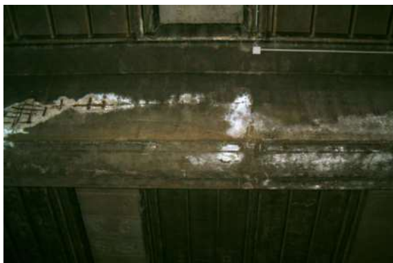
Fig.9 – Degradamento di una trave precompressa di un capannone.
