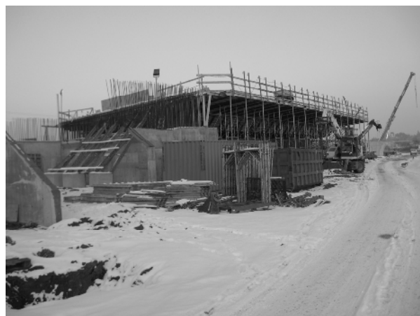
Fig. 7 Spalla ovest e puntellazione per il getto della prima campata del viadotto
