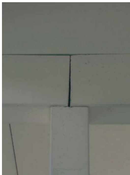
Figura 8 Conseguenze sulle strutture del cedimento dell'intero sistema terreno-struttura
