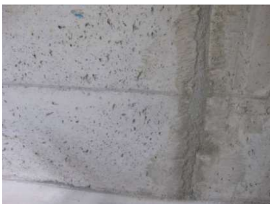
Figura 2 Evidenza della scadente posa in opera
