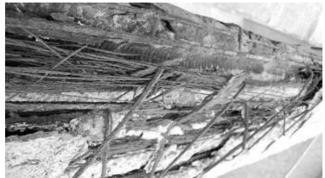
Figura 4 - Corrosione dei trefoli
