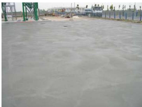
Figura 10 – Vista di un pavimento industriale in Calcestruzzo privo di giunti di contrazione
