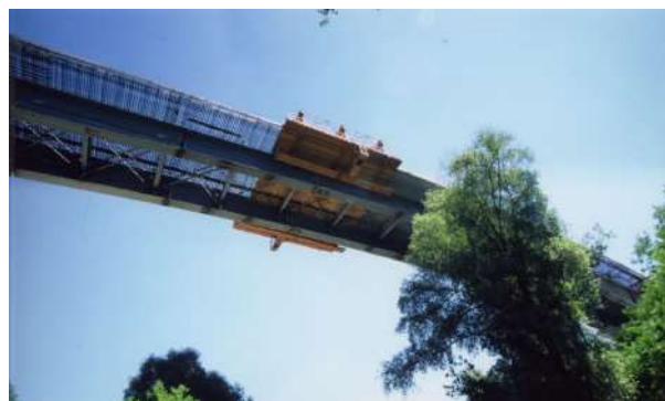
Figura 1 - Impiego di casseri mobili nel getto della soletta di un viadotto a trave continua composta acciaio-calcestruzzo
