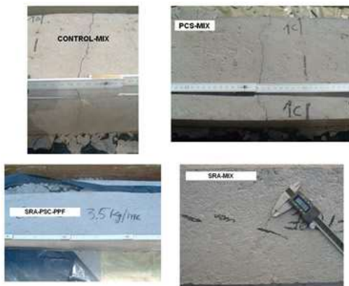
Figura 6 – Comportamento fessurativo del calcestruzzo nelle prove di campo
