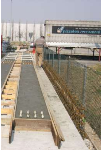
Figura 5 – Campo prove per visionare il comportamento fessurativo su lastre in calcestruzzo lunghe 8 m, larghe 400 mm, e spesse 60 mm
