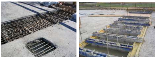
Figura 9 – Sistema con soletta post-connessa: (a) schema tasche e conci di sutura; (b) tasche di alloggiamento dei connettori e predisposizione del concio di sutura; (c) getto del concio di sutura
