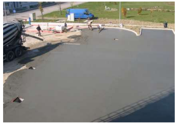
Figura 8 – Getto del calcestruzzo SRA-super-fiber-mix direttamente dall'autobetoniera per realizzare un pavimento industriale senza rete elettrosaldata
