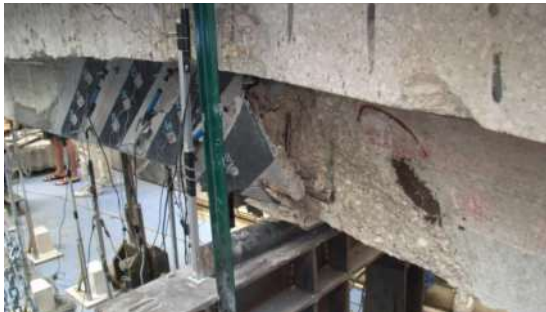
Figura 10 – Espulsione laterale del calcestruzzo per azione delle armature longitudinali inferiori.
