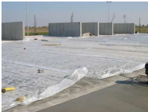
Figura 9 – Protezione del pavimento industriale in Calcestruzzo con foglio di plastica applicato dopo la sua finitura
