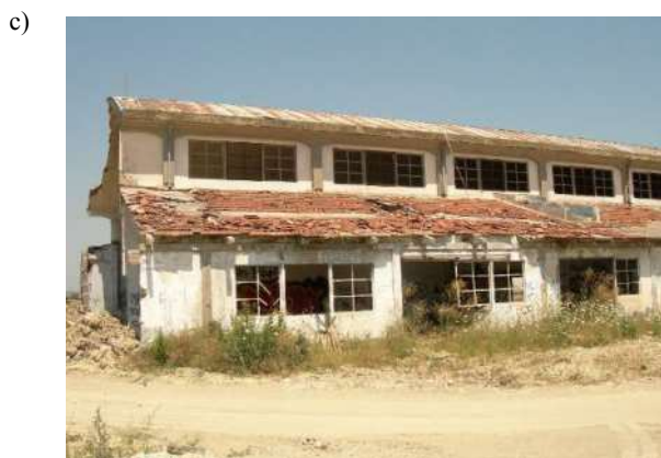
Figura 2 – Stato di conservazione dell’opera. a) Distacco del copriferro e corrosione delle armature sottostanti. b) Intradosso della volta di copertura, presenza di infiltrazioni di acqua con formazione di efflorescenze superficiali. c) Fenomeni avanzati di dissesto e degrado del corpo di fabbrica laterale
