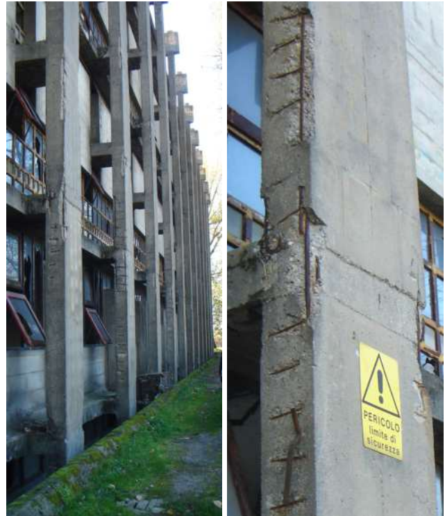
Figura 2 – Degradamento dei pilastri esterni dell'edificio principale
