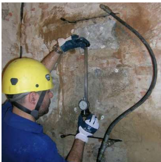
Figura 10 - Una delle prove eseguite con martinetti piatti doppi
