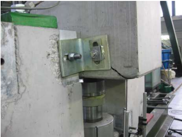
Fig. 13 – Prima prova: crisi lato calcestruzzo
