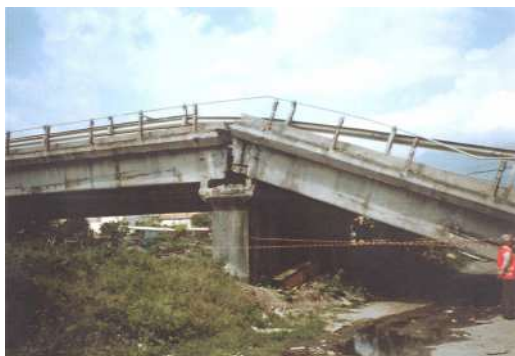
Figura 1 - Viadotto di S. Stefano dopo il crollo
