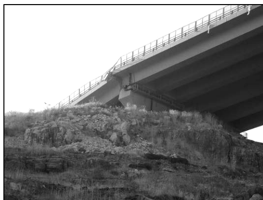
Figura 7 – Collasso della spalla C1
