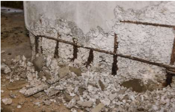
Figura 1 – Corrosione da carbonatazione
