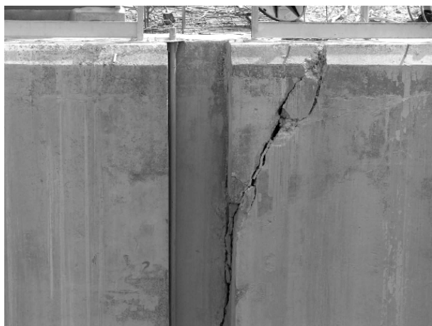
Lesione aggravata durante l'esecuzione dei pali
