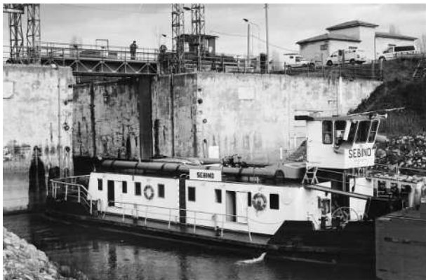
Nella foto si vede, da valle, la chiusa con porta traslabile mentre il rimorchiatore in manovra genera vortici che scazano alle fondamenta la struttura in c.a.
