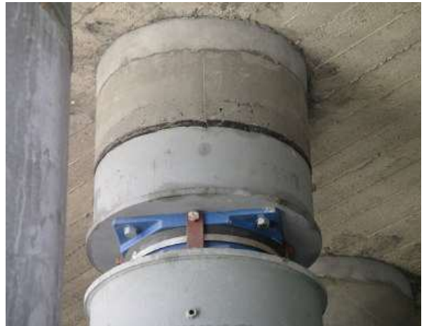
Foto 5 – Collocazione dei dispositivi di isolamento sismico del tipo a pendolo ad attrito.
