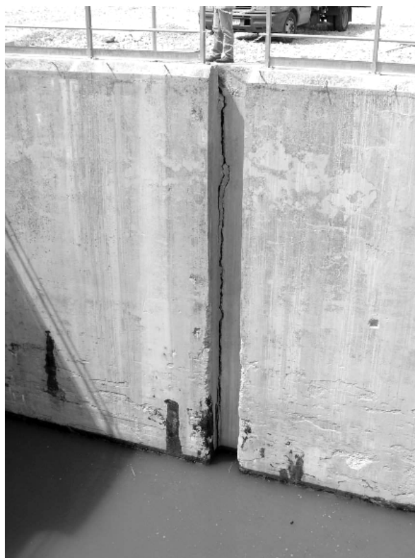
Altra lesione aggravata durante l'esecuzione dei pali
