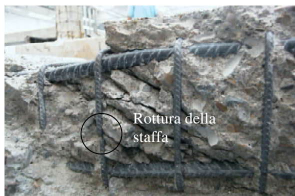
Figura 16 – Trave G. Collasso della trave per snervamento e rottura di una delle staffe
