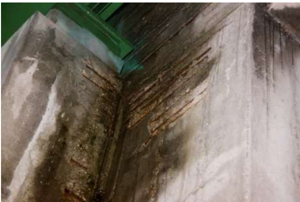
Figura 2 – Corrosione per attacco di cloruri
