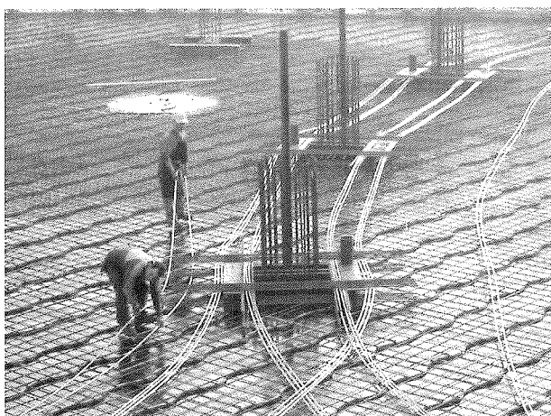
Fig. 7 : Passaggio dei cavi sui capitelli metallici
