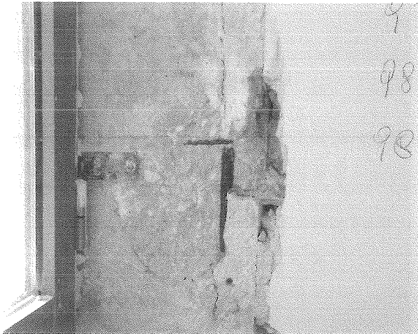
Foto 3 – Corrosione delle armature di un pilastro
