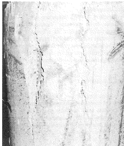
Fig. 11 - Distribuzione delle fessure verticali in corrispondenza delle barre longitudinali nella colonna armata e non fasciata
